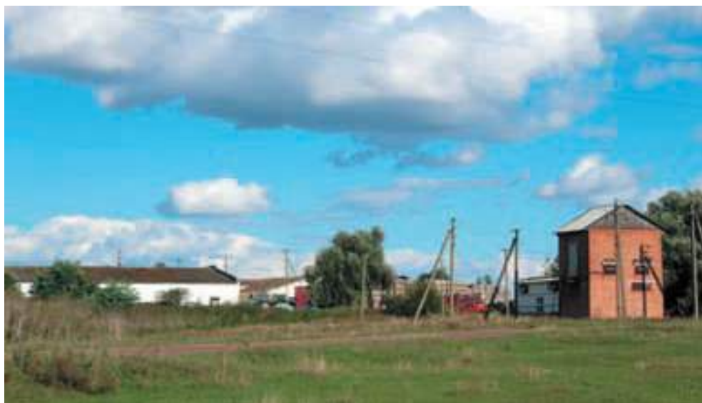
Діючий трансформатор колишнього колгоспу
