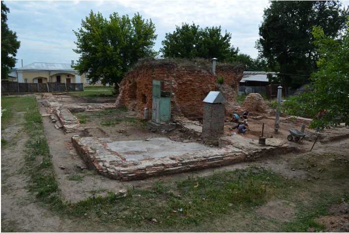
Рис. 9. Дослідження залишків Петропавлівської церкви з трапезною (1670-ті рр.) на території Єлецького монастиря у Чернігові. Фото 2013 р.
